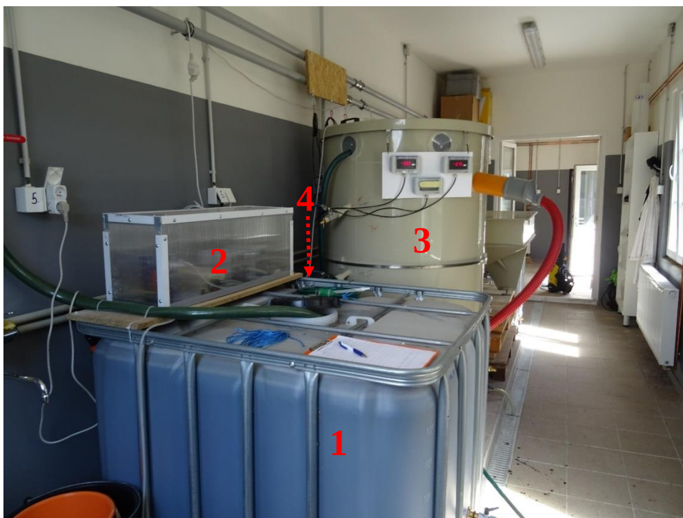
Obrázek 1: Fotografie poloprovozního nitrifikačního reaktoru pro zpracování fugátu (1 – zásobník vstupního fugátu; 2 – čerpadla pro transport fugátu a dalších tekutin; 3 – vlastní nitrifikační reaktor; 4 - membránové dmychadlo)
